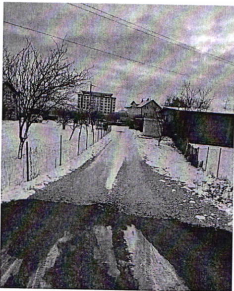
Slika 3: ulica u kojoj je potreban asfalt (cca 100m 2 )
